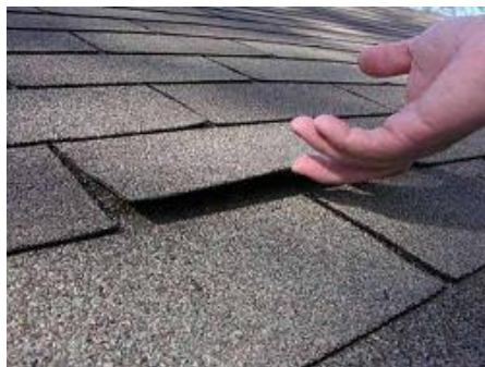
Loose Shingle Tab
